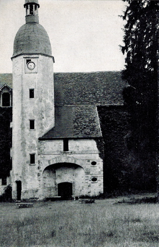
La jolie tourelle octogonale du grenier d'abondance contient l'escalier qui mène aux différents étages.
