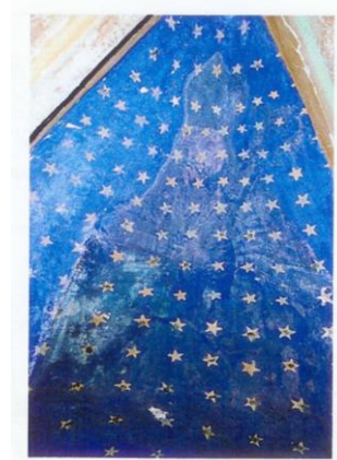
Etat des peintures de la voûte avant sondages (Serre, 2002)
